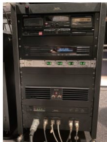
2 階周辺機器ラック
