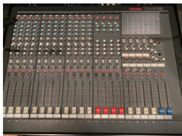
2 階ミキシングコンソール
